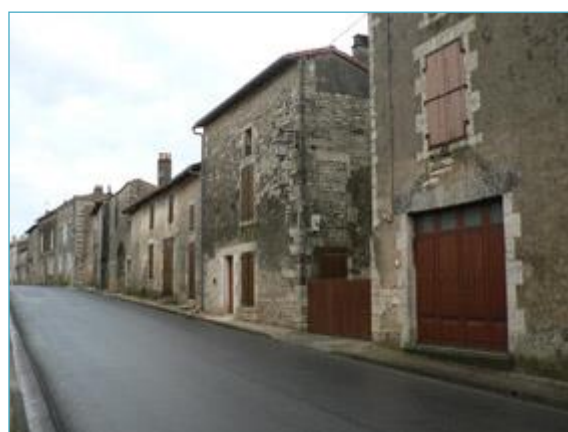
Bâti ancien en désuétude le long de la voie principale
