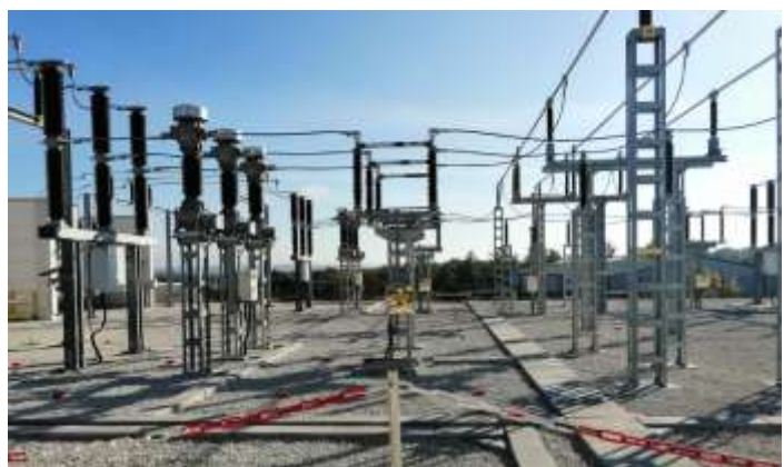
Figure 5: séparation physique entre le réseau géré par Enedis à gauche et celui de RTE à droite (90kV)
