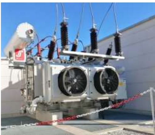
Figure 4: transformateur 36MW pour abaisser la tension de 90kV à 20kV
