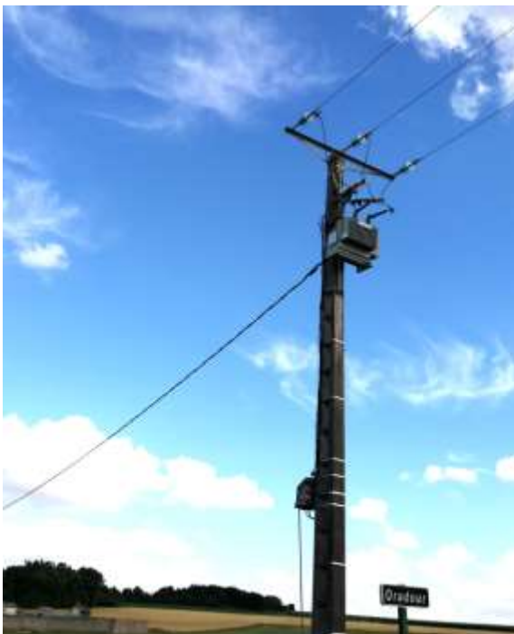
Figure 27: transformateur passant l'électricité moyenne tension (20kV) à basse tension – ligne aérienne à Oradour
